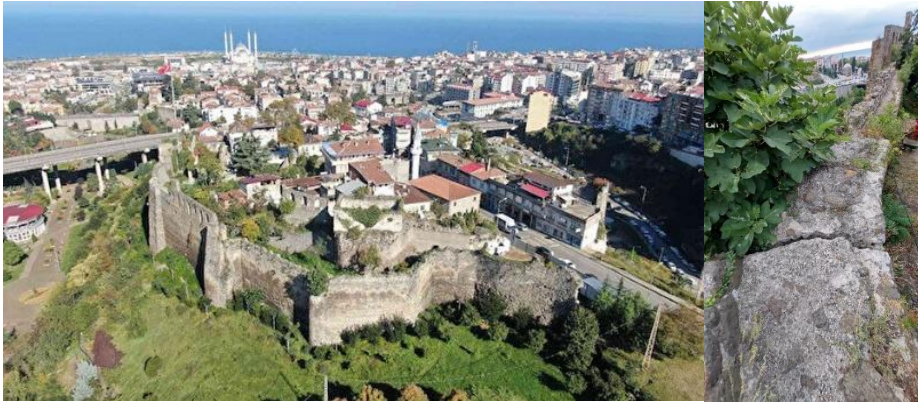
Resim 5. Trabzon İç Kale surları ve derin çatlaklar
