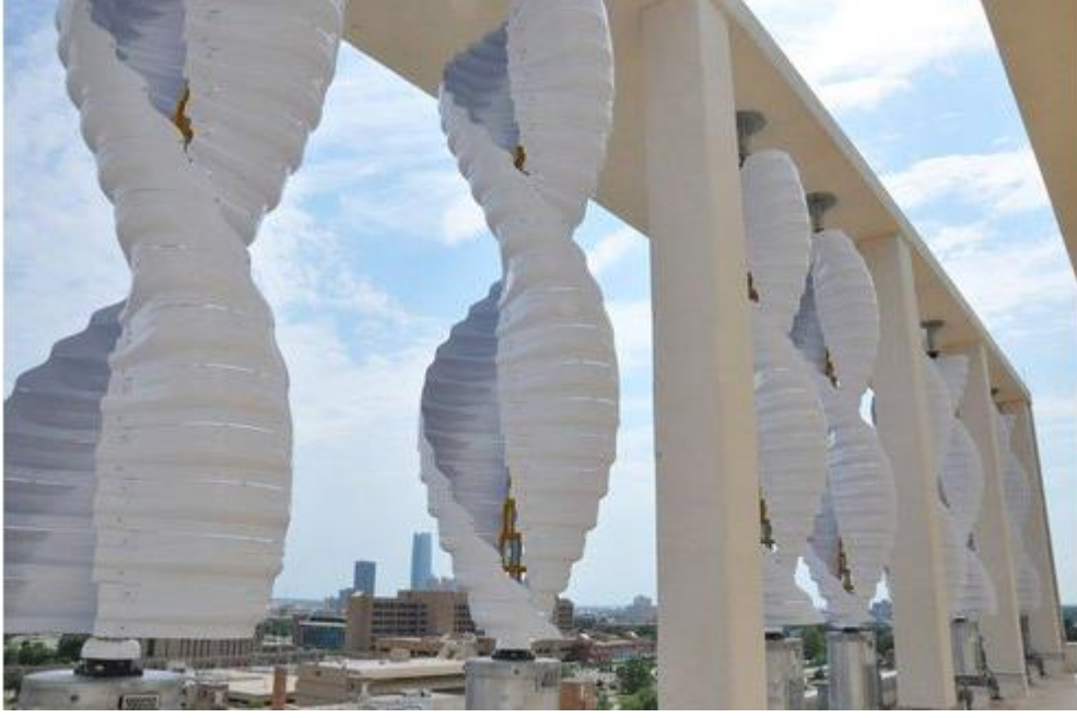
Şekil 1.13. ABD’ de Oklahoma tıp arařtırmaları vakfı çatısında kurulu rüzgar türbinleri
